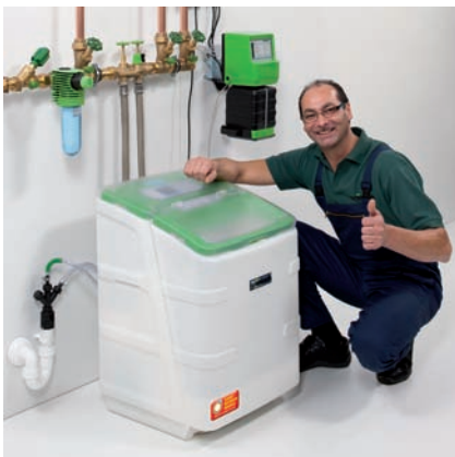
Einbaubeispiel: Weichwassermeister® GSX und Dosiertechnik EXADOS®
