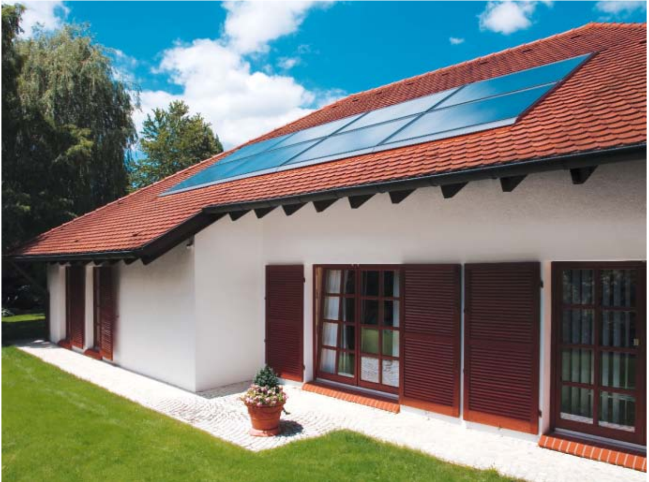
Kollektoranlage zur kombinierten Trinkwassererwärmung und Heizungsunterstützung
