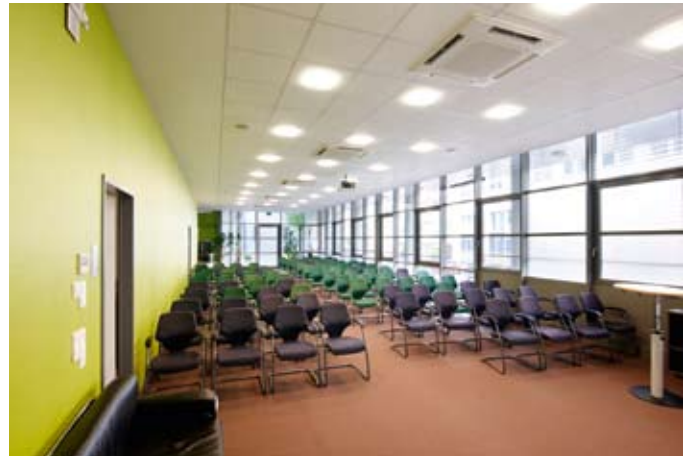
Der Konferenzraum wird über drei große Deckengeräte klimatisiert; gleichzeitig werden aufgrund der eingesetzten Reinigungstechnik Sporen, Bakterien und Pollen für eine hygienische und saubere Atemluft herausgefiltert
