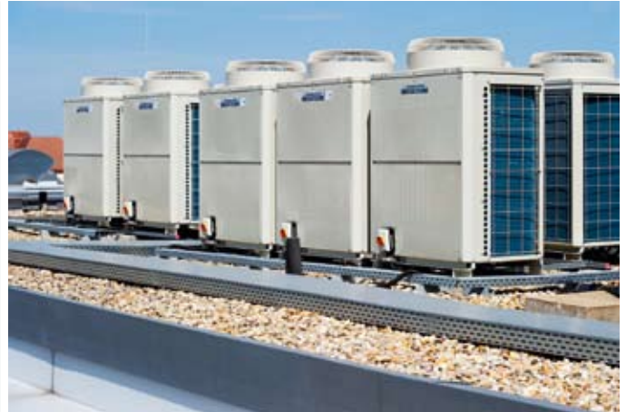
Die Nachrüstung eines Gebäudes mit VRF-Klimageräten erfordert nur einen geringen baulichen Aufwand, da lediglich die Außen- und Innengeräte aufgestellt und verbunden werden müssen
