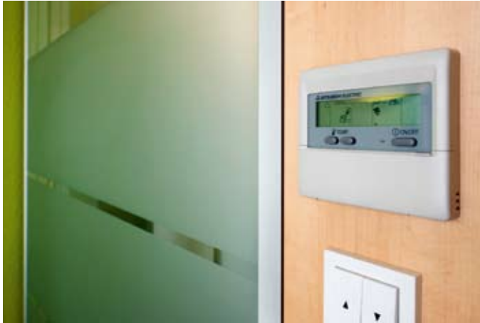
Eine individuelle Steuerung der Temperatur über Einzelraumfernbedienung ist möglich; allerdings wurden auf der übergeordneten Zentralfernbedienung Soll-Werte und Rahmendaten hinterlegt
