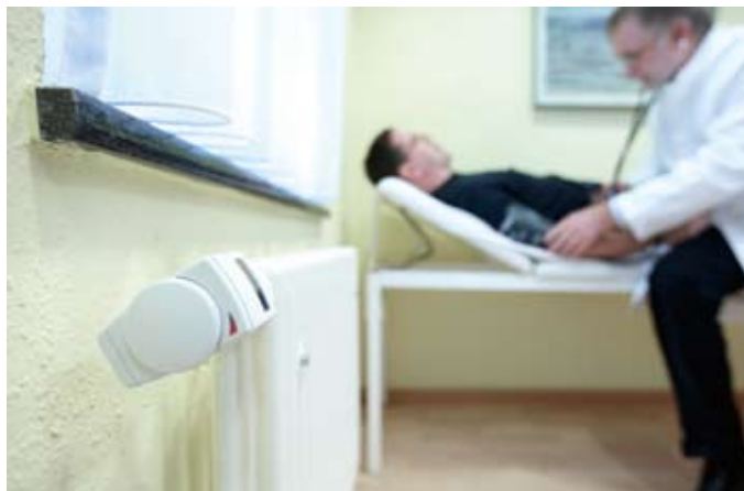
Bild 6: Die Behandlungszimmer sind zu den genutzten Zeiten warm, und die Temperatur lässt sich auch an jedem Heizkörper manuell regeln
