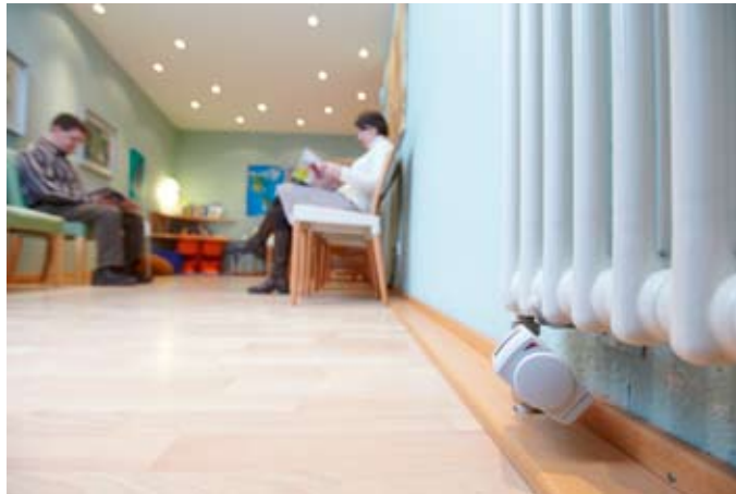
Bild 4: Die Regler sind mit einer Sicherung versehen, so dass die Temperatur z. B. hier im Wartezimmer manuell nur bedingt verstellt werden kann
