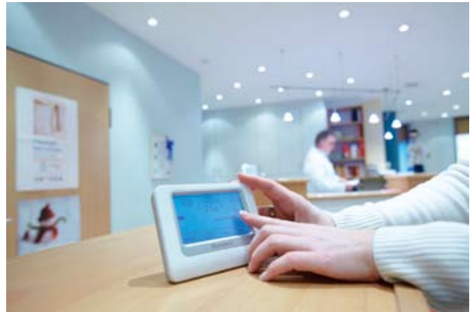
Bild 5: Die Temperaturen in den einzelnen Räumen lassen sich einfach per Knopfdruck verändern
