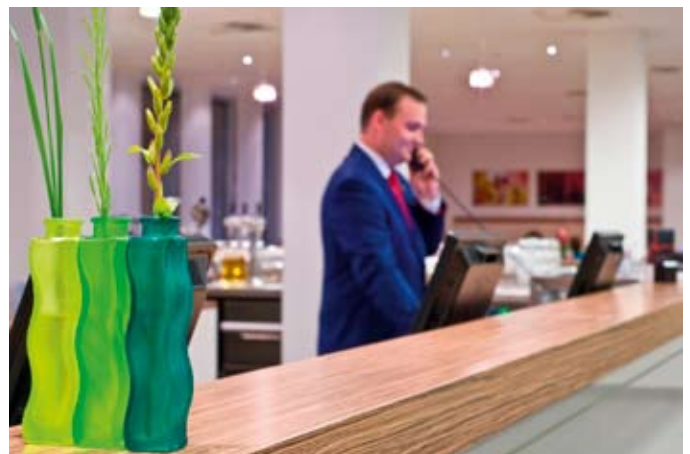
Rezeptions- und Restaurantbereich sowie Tagungsräume werden über Deckenkassetten im Eurorastermaß klimatisiert; sie sind sehr leise und integrieren sich durch eine Blende in RAL 9010 hervorragend in die helle Innenarchitektur
