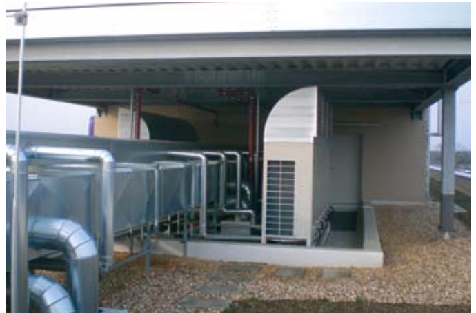
Die Außengeräte stehen, vor Schnee und Eis geschützt, auf dem Dach; das installierte VRV-System von Daikin meisterte selbst den Dezember 2010 mit Temperaturen im zweistelligen Minusbereich und hohen Mengen an Schnee und Eisregen mühelos
