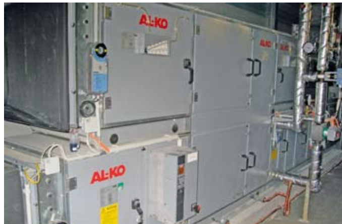
Lüftungsanlage für den Wellnessbereich
