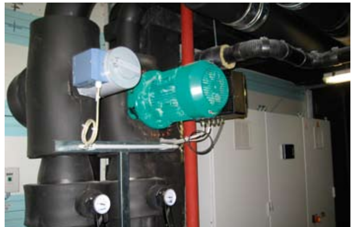
Warmwasserversorgung für den Wellnessbereich
