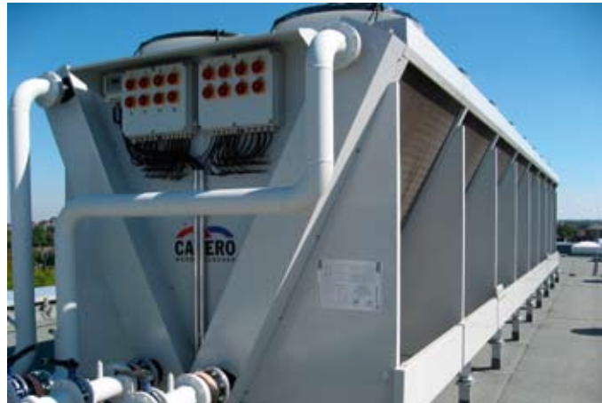
Rückkühler auf dem Dach
