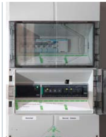
Der „GeniAx-Server“ ist über eine 0 bis 10 V-Schnittstelle mit dem Wärmeerzeuger verbunden, so dass er auf Basis der Daten aus den Raumbediengeräten eine bedarfsgeführte Vorlauftemperatursteuerung erlaubt
