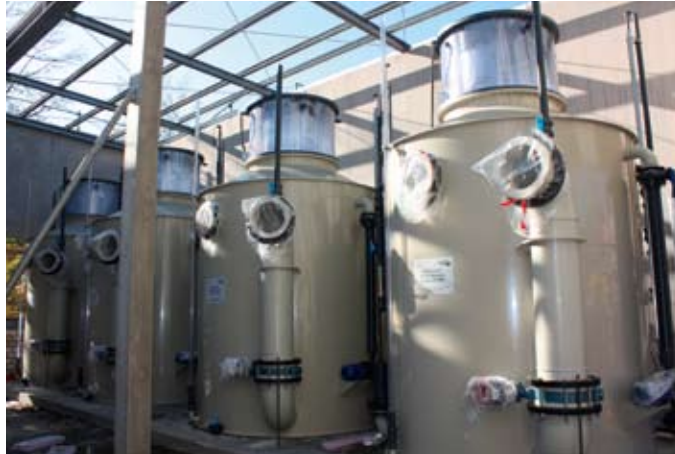
... im Technikraum hinter den Wasserbecken
