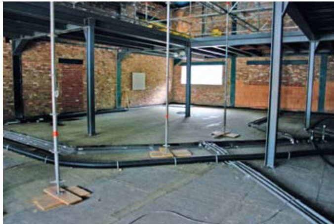
Blick in eines der Häuser des entstehenden „Hafenstädtchen Yukon Bay; gut zu erkennen ist die Bemusterung der Lüftungstechnik im Hintergrund links oben
