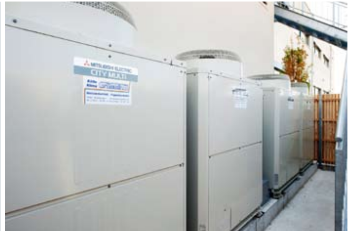
Vier Außengeräte genügen, um das Gebäude zu heizen, zu kühlen und täglich mindestens 8000 l Warmwasser bereitzustellen
