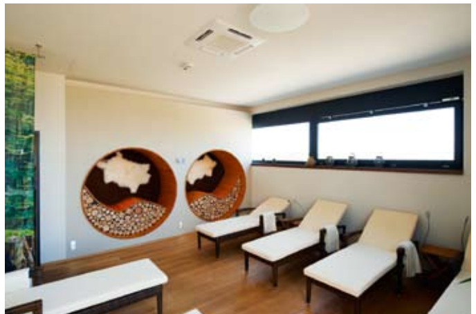
Die Deckenkassette sorgt für eine angenehme und zugluftfreie Temperierung der Räume
