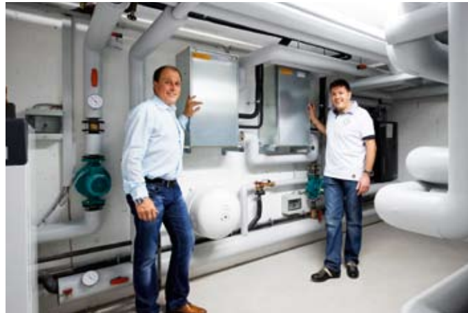
Kai-Uwe Gaupp (links), Mitsubishi Electric, und Dipl.-Ing. Frank Grässlin, Kälte-Klima Grässlin, vor den beiden Wassermodulen (Booster-Units) zur Brauchwassererwärmung
