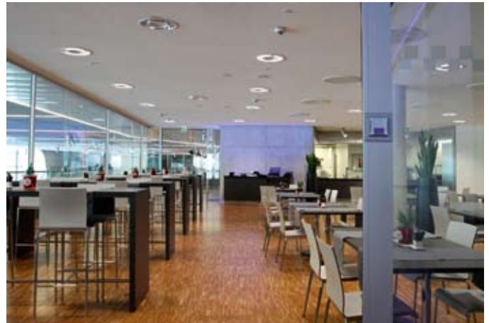
Der zeitgemäße Trucker-Treff ist klimatisiert, im MAN Forum sogar über eine Kühldecke; im Vordergrund ein Funk-Temperaturfühler
