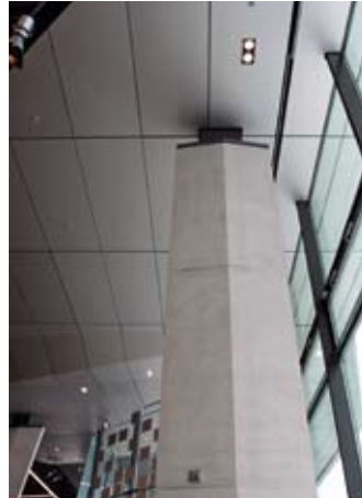
Funksensor an der Hallendecke und am Pfeiler: Die Platzierung der Sensoren erfordert sehr viel Erfahrung
