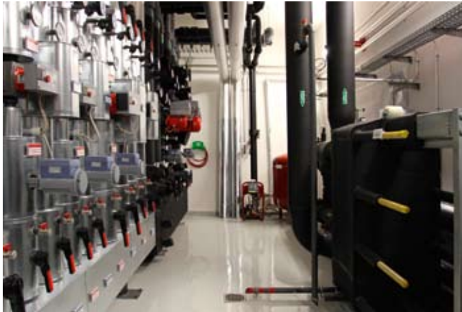
Heizungs- und Kälteverteilung, rechts der Plattenwärmeübertrager für Deckenkühlung und RLT-Anlagen
