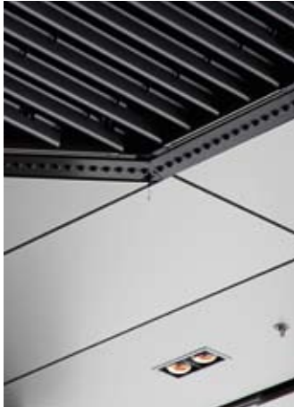
Decken-Detail mit Kühldecke und Funkantenne zur Datenübertragung von Temperatur
