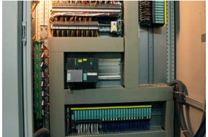
Die „Simatic S7“-Automationsstationen sind über ein Industrial Ethernet mit dem werksseitigen „Siclimat X“-Gebäudeautomationssystem verbunden
