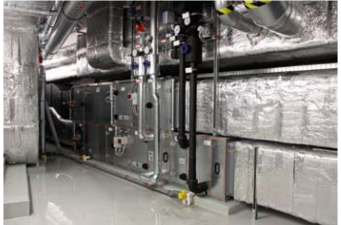
Die Klimaanlagen sind im Untergeschoss platziert; gekühlt wird umweltschonend mit Grundwasser
