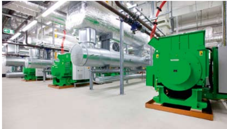
Die drei BHKW im Wirtschaftsgebäude
