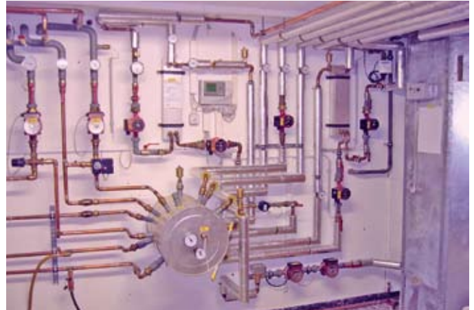
Bild 1: Über den Zortström-Verteiler erhält sowohl das Brennwertheizgerät als auch der angeschlossene Solarkreislauf die benötigten tiefen Rücklauftemperaturen
