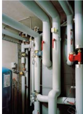
Der Wärmespeicher im Technikraum
