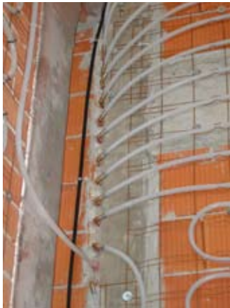
Das Kühlen und Heizen wird im Museum Brandhorst mit demselben Rohrverteilungssystem und im gesamten Gebäude mit rund 35 Heiz-/Kühlkreisläufen vorgenommen
