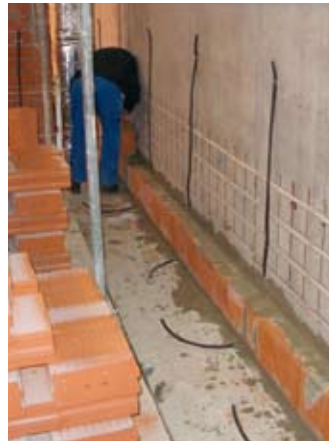
Nach dem Verpressen der Rohre wurde ein 4 cm großer Hohlraum für die Rohrstränge der Betonkernaktivierung gelassen; vor diesen Hohlraum wurde eine Wand mit 11 cm starken Ziegelsteinen als Verschalung mit entsprechenden Aussparungen gemauert
