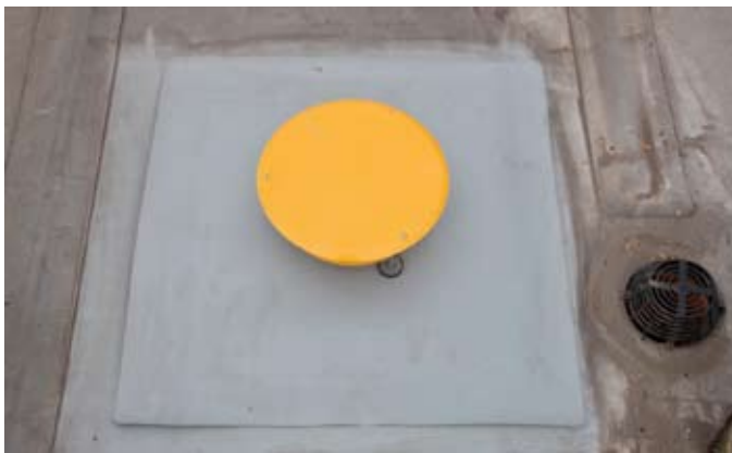
Das „Sita“-Anstaelement wurde mittels der höhenverstellbaren FüÙe exakt auf die definierte Anstauhöhe von 35 mm justiert; übersteigt der Wasserspiegel bei Starkregen diese Höhe, tritt die Notentwässerung in Aktion
