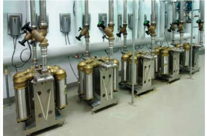
Für einen optimalen Kalkschutz, der auch den hohen Temperaturen des Plattenwärmetauscher-Systems gerecht wird, wurden Geräte der Serie „permasolvent primus“ eingesetzt
