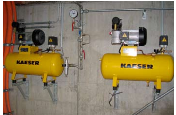
Kompressoren in der Sprinklerzentrale
