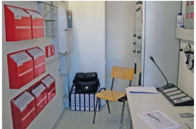
Die Brandmeldezentrale in der Eingangshalle
