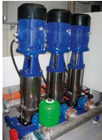
Pumpen in der Sprinklerzentrale
