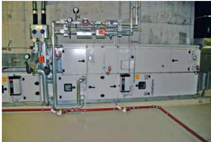
Eine kleinere RLT-Anlage die einen der Nebenbereiche mit Frischluft versorgt
