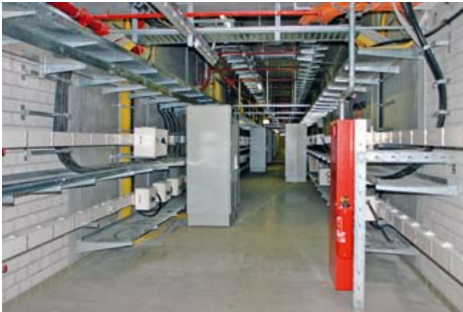
Blick in die Versorgungsbereiche unter der Halle
