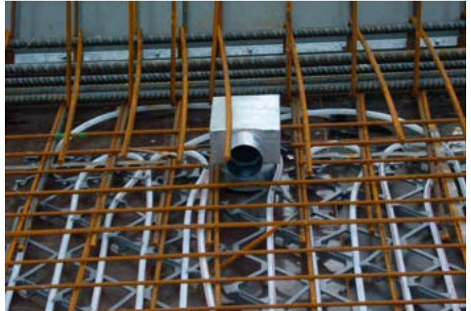
... die Zuluftverteilung im Gebäude deckenintegriert ...
