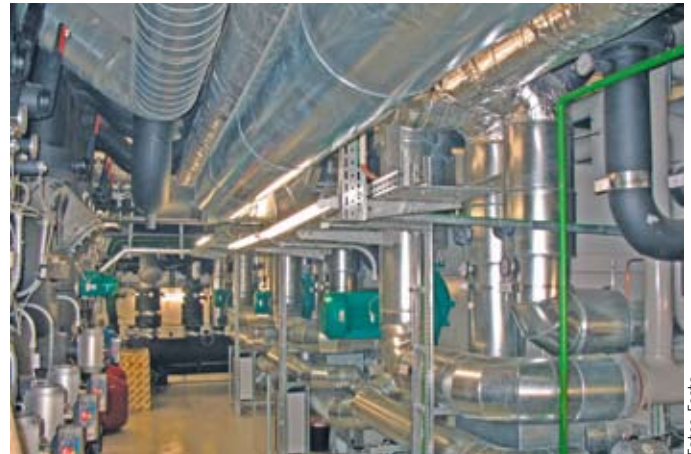
Bild 1c: Blick in die Kältezentrale; rechts die drei Adsorptionskältemaschinen
