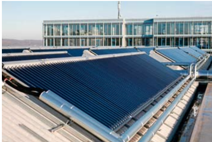
Bild 1b: Vakuumröhren-Kollektorfeld auf dem Sheddach einer Fabrikhalle
